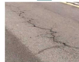
●舗装のひび割れの様子。
