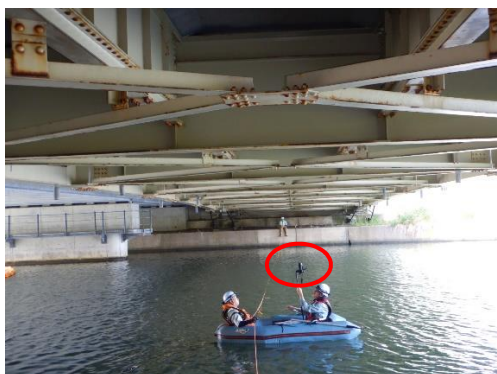
損傷箇所の写真撮影
