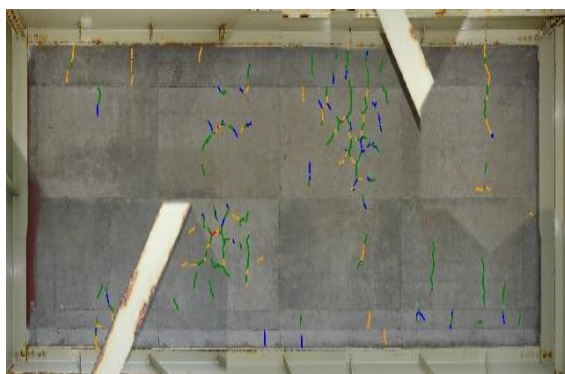
損傷検出合成画像
