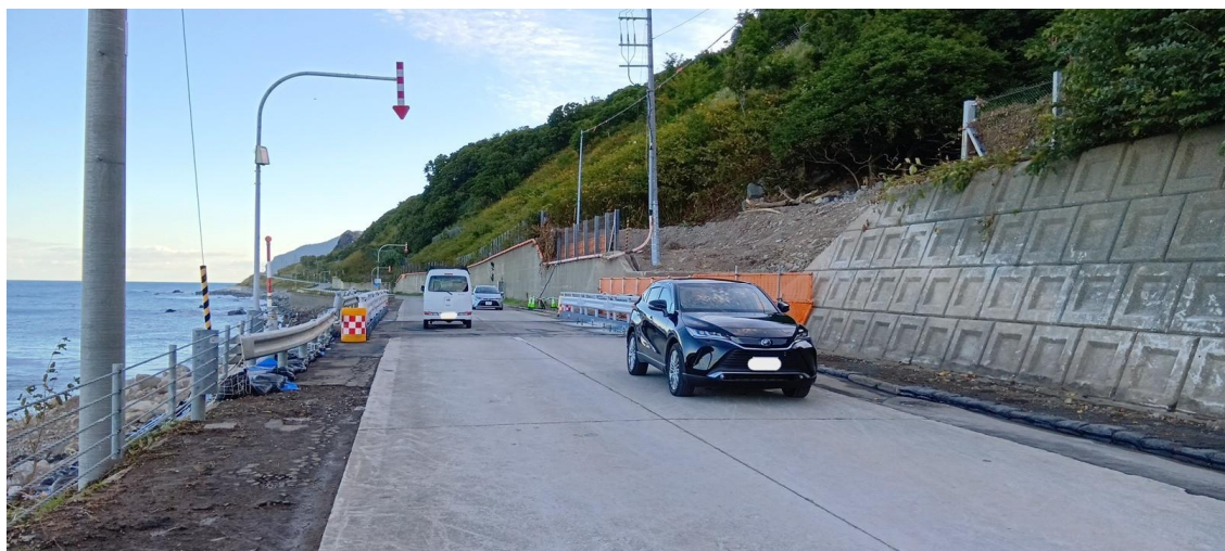
▲通行止め規制解除状況 9月11日(金) 7:00現在
