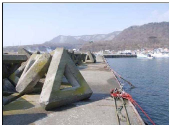
庶野漁港 (消波ブロック散乱状況)
