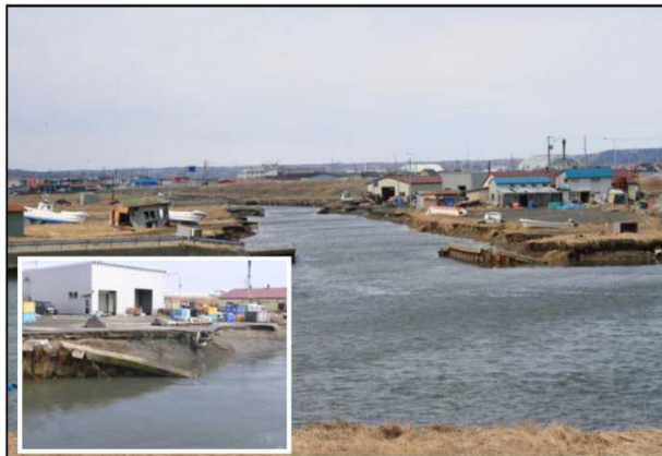
霧多布港 (矢板護岸工の被災状況)
