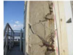
水門の門柱部のコンクリ剥離
