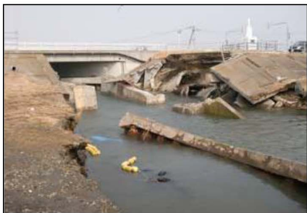
橋梁脇の堤防決壊 (霧多布)
