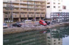
鋼矢板護岸の損壊状況
