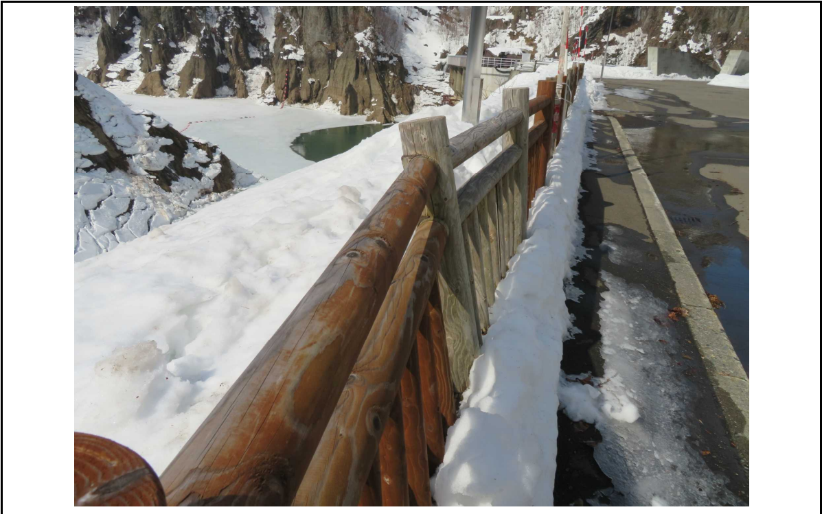
○撮影場所：豊平峡ダム 湖岸周辺 ○写真説明：転落防止柵(木柵)ぐらつき(4月下旬 補修予定)
