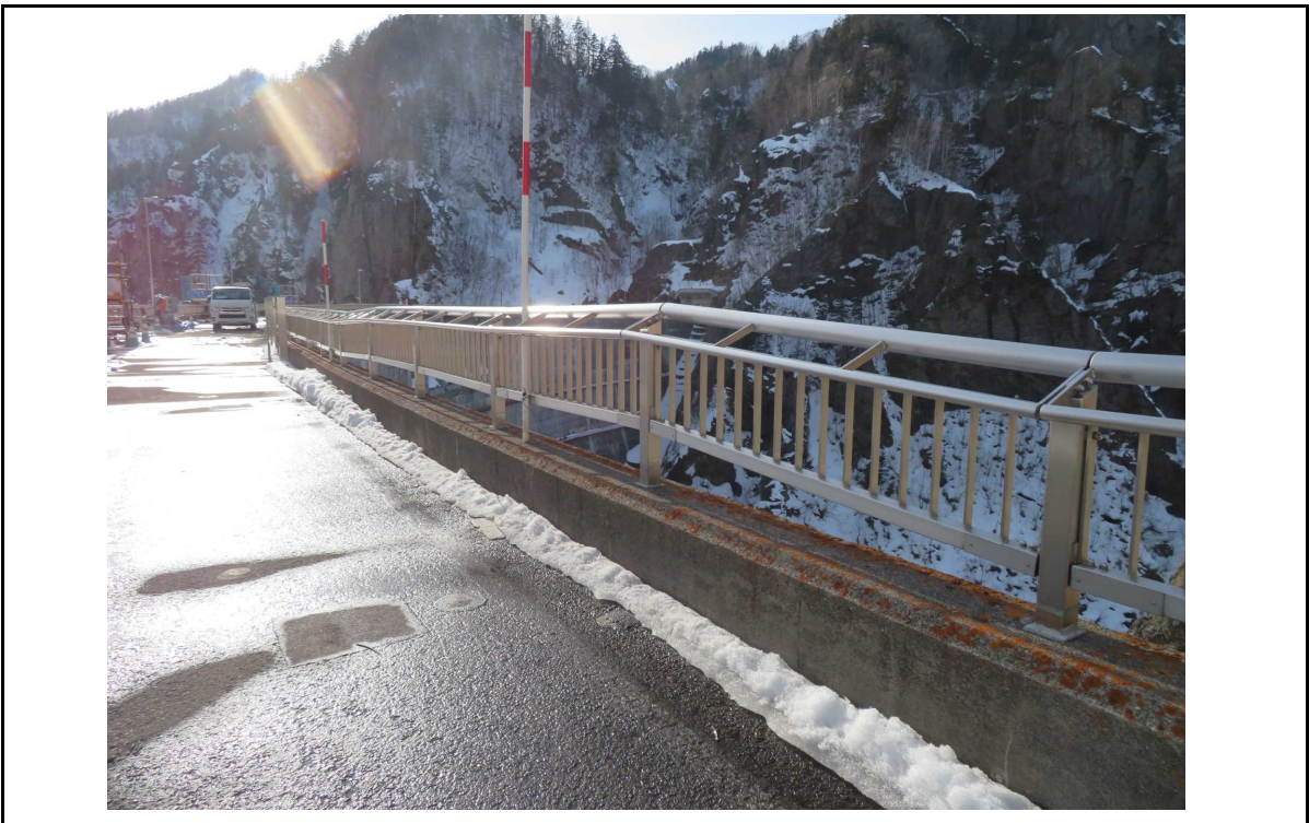
○撮影場所：豊平峡ダム 堤頂 ○写真説明：高欄浮き上がり状況(4月下旬 補修予定)
