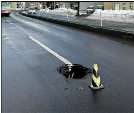
道路陥没における技術指導① 【発生初期の状況】
