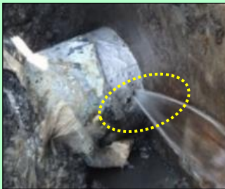
八幡幹線用水路の漏水状況 ●用水施設の機能低下
