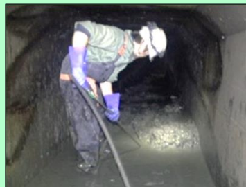
堆積土砂撤去状況（中島揚水機） ●土砂堆積による取水阻害
