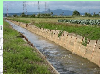
整備前の排水路（断面不足・老朽化）
