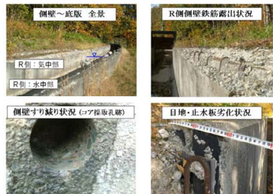
写真-7 劣化状況
