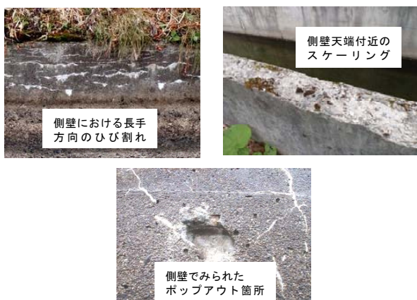
写真-1 水路における凍害劣化の形態
