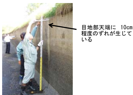
写真-2 凍上による水路側壁の傾倒
