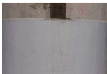
写真-8 ひび割れた保護材の表面を伝う水の状況 (写真-7の点線部拡大)
