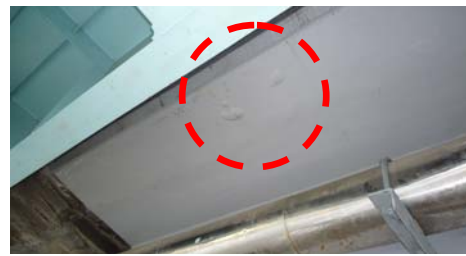
写真-2 目視で確認できる「浮き」
