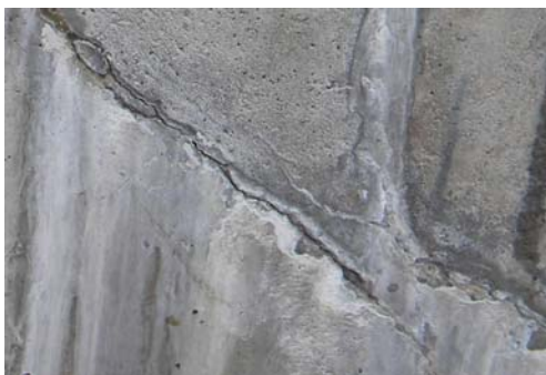
写真-1.1 注入不足等による再びび割れの例
