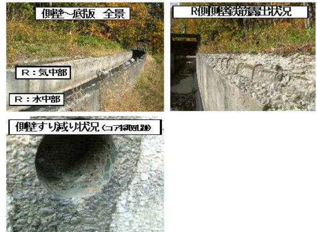
写真-3 劣化状況
