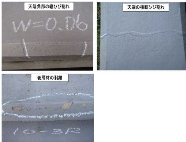
写真-5 レジンモルタル工法の変状
