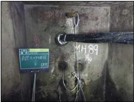
点検状況(マンホール壁面モルタル剥離確認)
