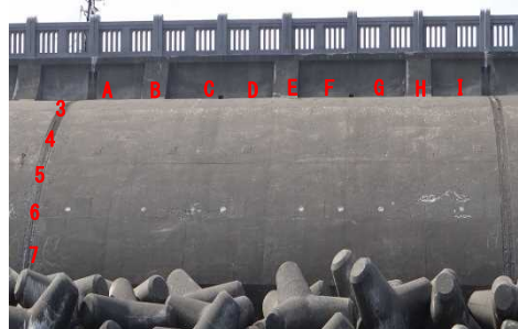
床版部外面の変状状況
