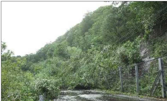
【表層崩壊箇所での現地状況】
