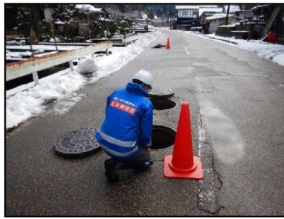
【被災施設の調査】
