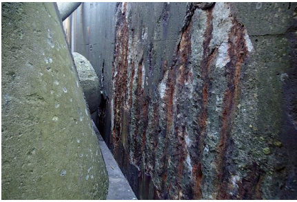
厳しい波浪環境にさらされる床板外面では、コンクリートの剥離とこれに伴う鉄筋腐食が発生
