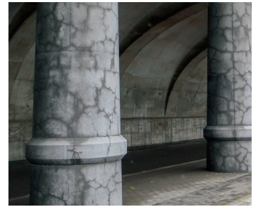
柱部表面に網状のひび割れが発生し、耐久性低下や景観に悪影響
