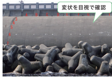
床版部外面の変状状況 (補修前)
