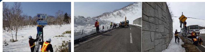
標識、ガードケーブル等、道路付属物の復旧状況
