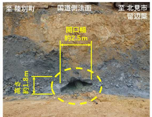
△道路敷地内の道路側に 空洞を確認
