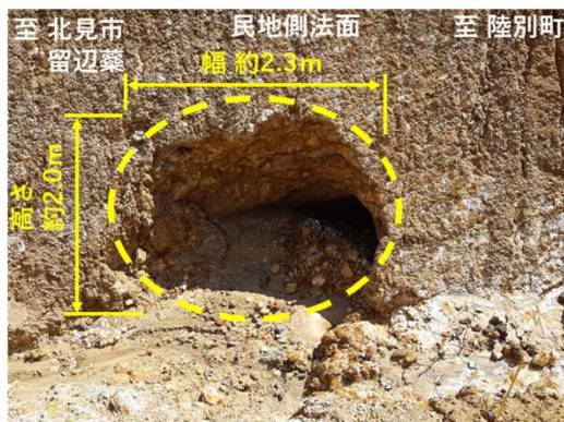
△道路敷地内の民地側に 空洞を確認
