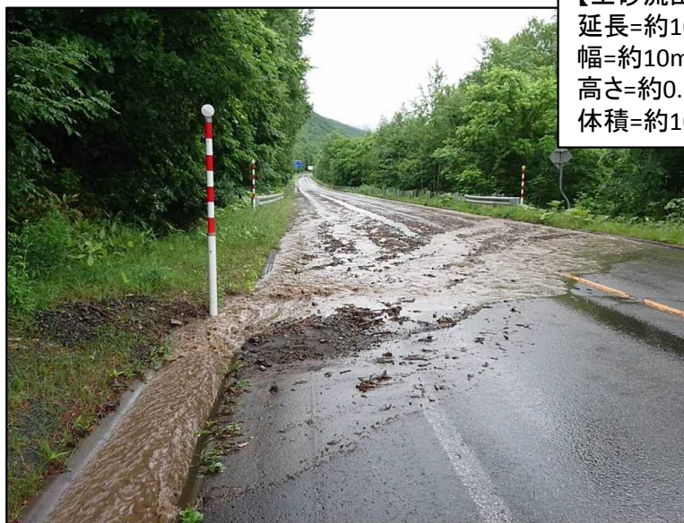
国道333号(KP33.2) 被災状況
