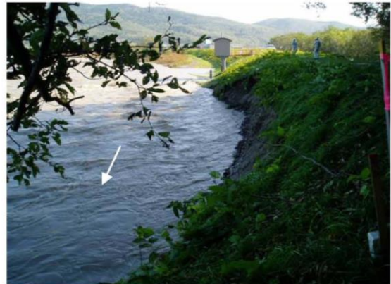
平成 18 年 10 月洪水状況 （開盛堤防の被災状況）
