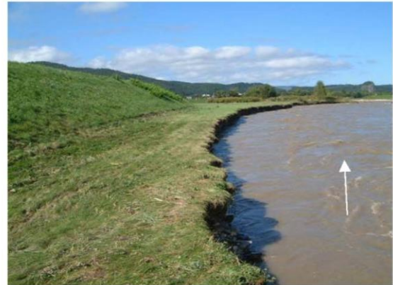
平成 13 年 9 月洪水の状況 （野上左岸高水敷の被災状況）
