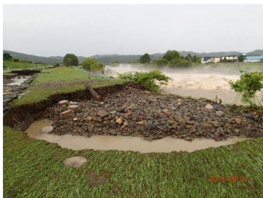
平成 28 年 8 月洪水の状況 (遠軽町大通南の高水敷洗掘状況)
