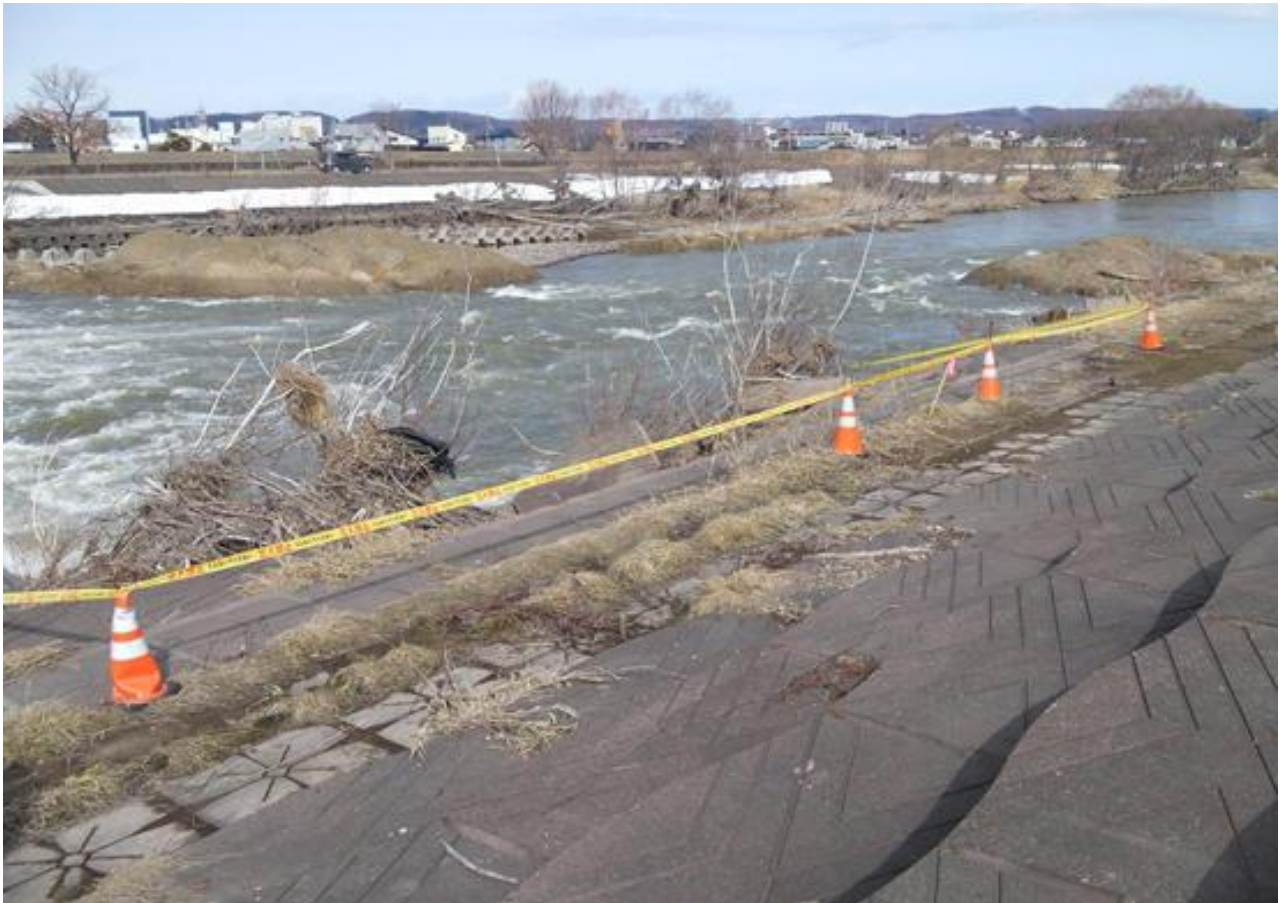
○写真② 川東パークゴルフ場付近右岸:階段護岸に崩れ有り
