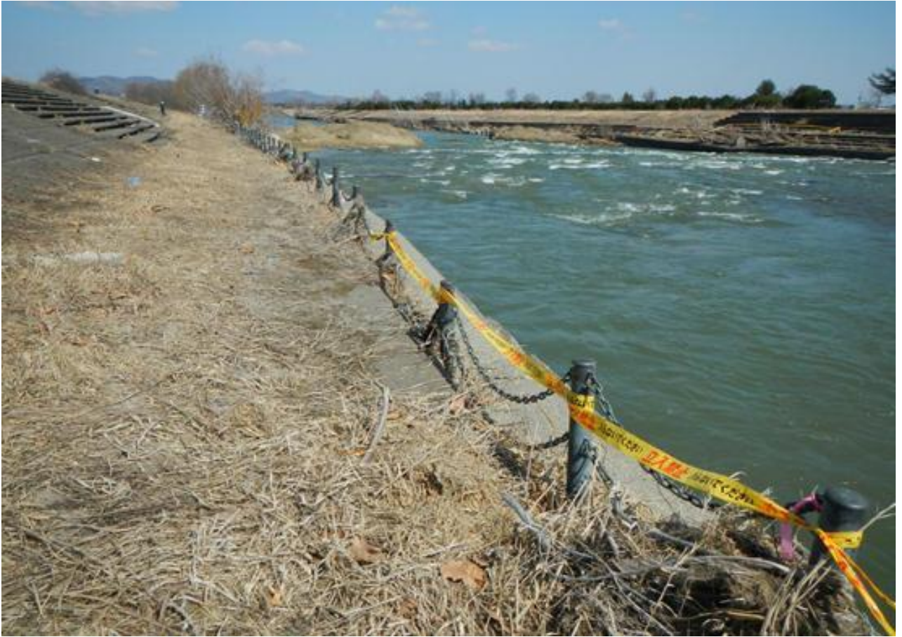
○写真① 若松大橋付近左岸:転落防止チェーンに損傷有り
