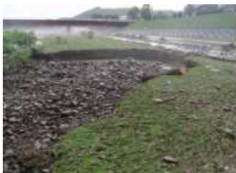
平成28年洪水 高水敷洗掘状況
