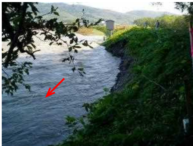
開盛堤防の被災状況
