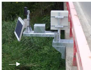
危機管理型水位計などの設置
