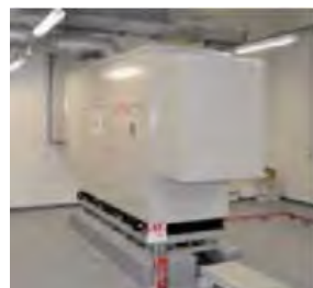
非常用発電設備のイメージ
