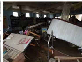
令和2年7月豪雨の被害
