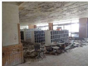
平成30年7月豪雨の被害
