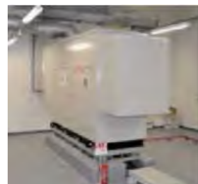
非常用発電設備のイメージ
