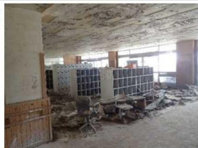
平成30年7月豪雨の被害
