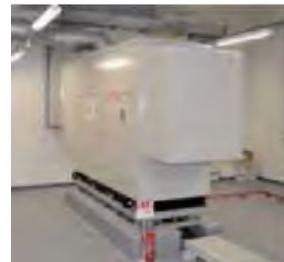
非常用発電設備のイメージ
