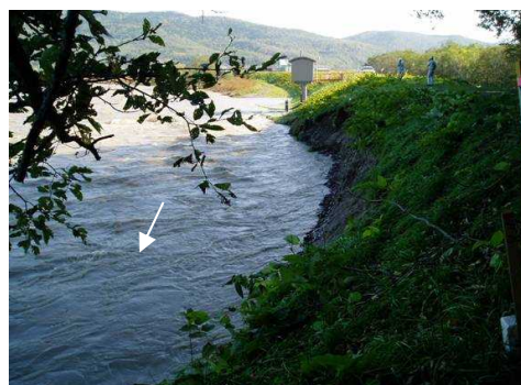
平成18年10月洪水の状況 (開盛堤防の被災状況)
