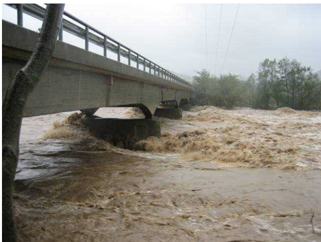
平成18年10月洪水の状況 (記念橋下流の洪水流下状況)
