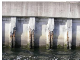
特殊堤の老朽化状況
