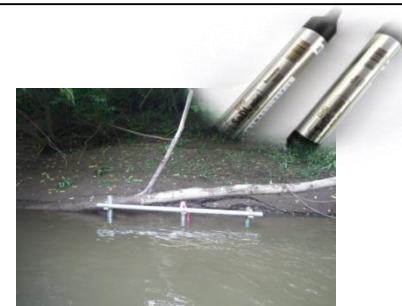
簡易水位計などの設置
