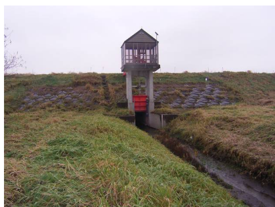
樋門周辺の護岸補修前 (土砂吸出し等による護岸沈下)
