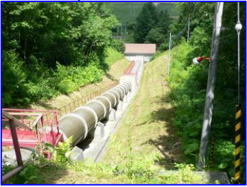
下津別発電所
