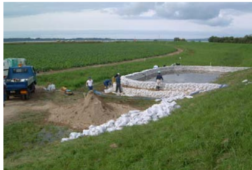
平成 13 年 9 月洪水の状況 (網走湖住吉地区の漏水時の状況)
