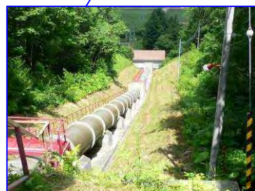
下津別発電所
