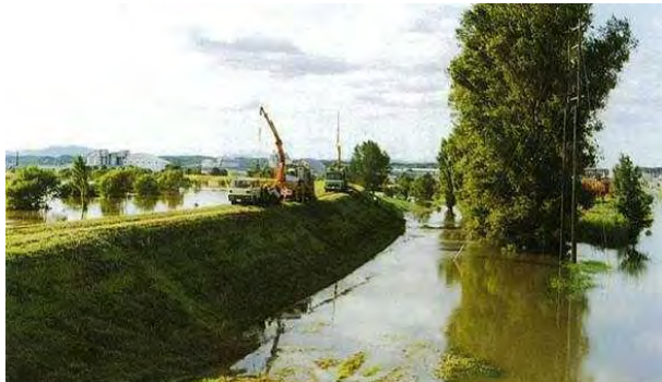
平成 4 年 9 月洪水の状況 はなみ (花見橋上流排水作業状況)
