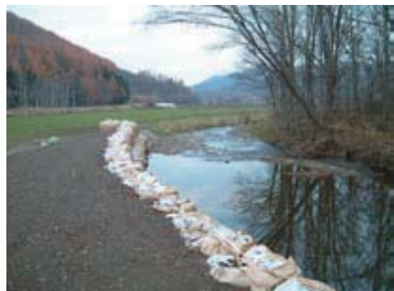
川沿いの農地で生じた溪岸侵食
