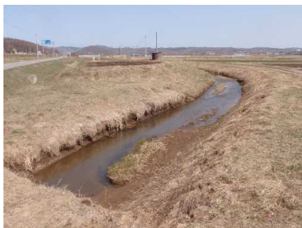
水路内の土砂堆積状況
