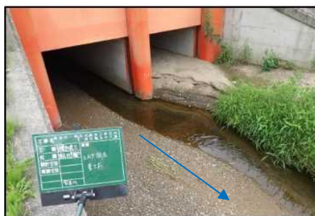
樋門吐口水路の土砂堆積状況
