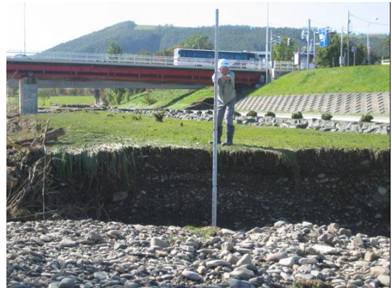
高水敷の洗掘被災
