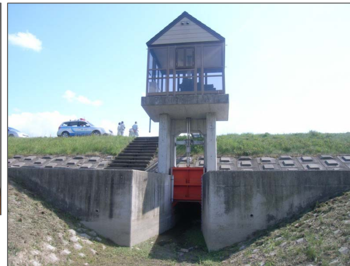
《樋門です … 雨水などを堤防の中を通して河川に流すために堤防に設置される施設》
