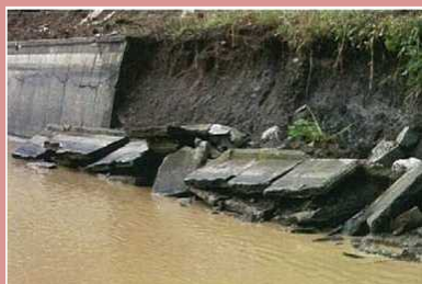
何か手当しないと劣化が進行し、施設が倒壊・破損（イメージ写真）
