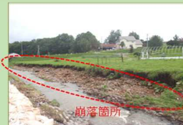
排水路護岸ブロックの崩壊被害 (H28)
