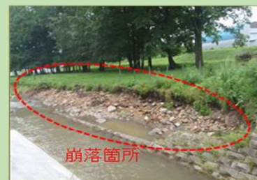
排水路護岸ブロックの崩壊被害 (H28)
