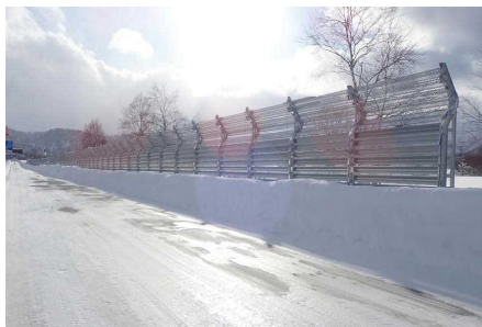
防雪対策(防雪柵)(国道275号 幌加内町)
