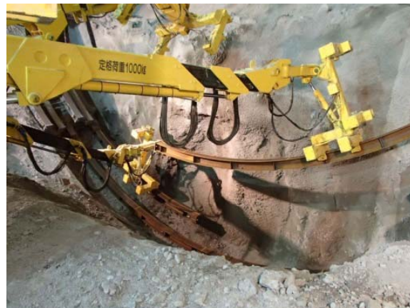
⑤鋼製支保工建込み状況 〔トンネル下半部分の支保工〕
