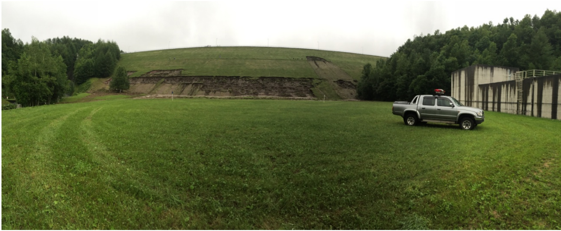
被災箇所の全景
