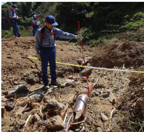
（7月13日 愛媛県宇和島市被災状況調査）
