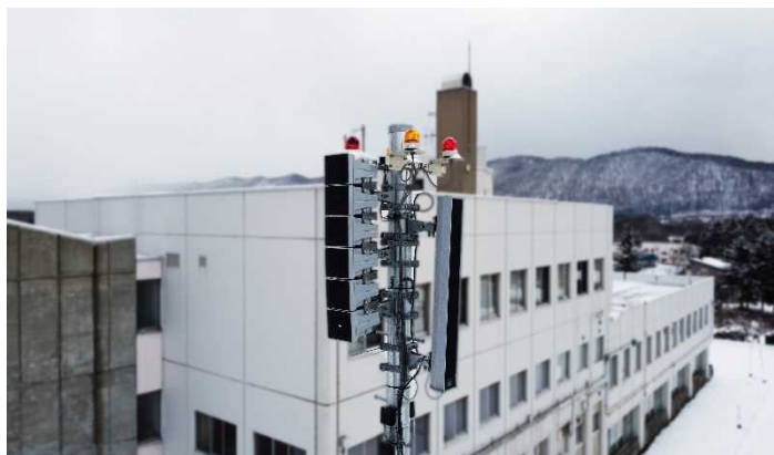
上川町役場屋外スピーカー現物写真
