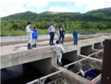
(6/5) 本川との接続箇所 ドラムスクリーン稼働状況確認
