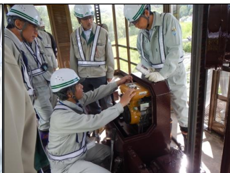
樋門操作訓練状況(職員)
