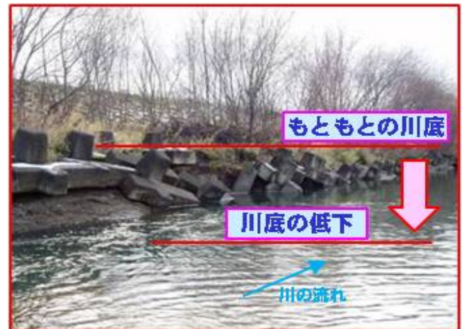
秋月橋下流左岸の状況(護岸ブロックの損傷)
