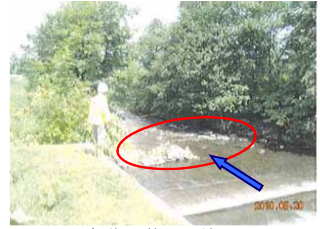
魚道(頭首工)下流の 連結ブロックの破損状況
