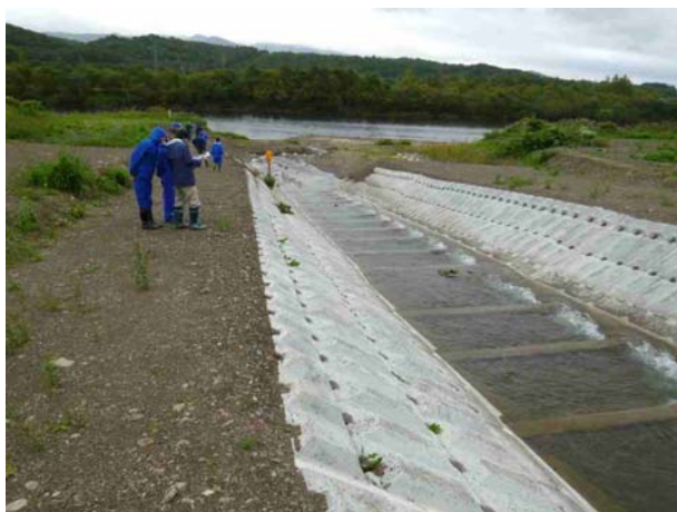
アラキの川階段式魚道の流況確認
