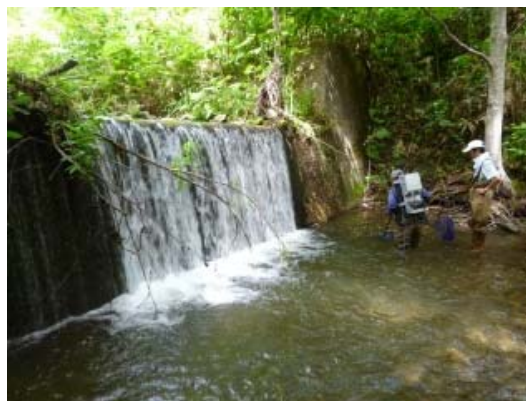
アラキの川床止工の 遡上改善現地協議
