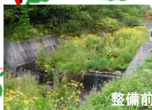
朝日六線川 5号床固工 魚道整備(H26.3予定)
