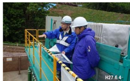
[ダムサイト濁水処理施設] 機械処理状況の確認
