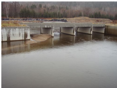
H27夏期出水による土砂堆積状況
