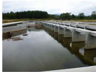
H26.8出水による土砂堆積状況
